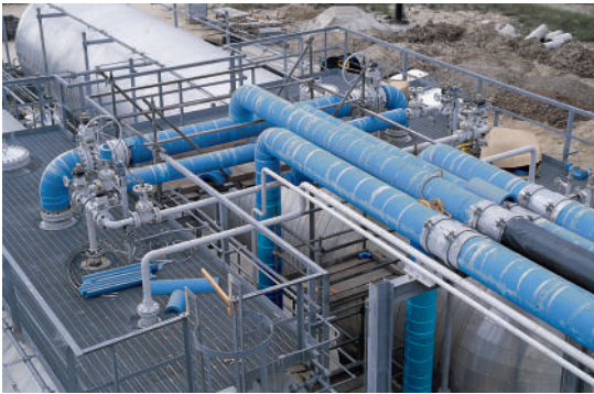
Isolant en mousse Trymer® utilisé pour l'isolation de tuyauterie pour la protection contre le gel.
